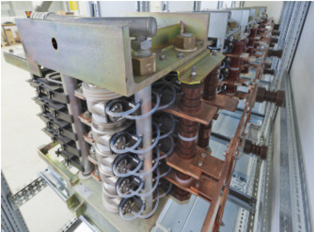
Foto 3: Leistungselektronik für zukünftige Mittelspannungs-DC-Netze.
