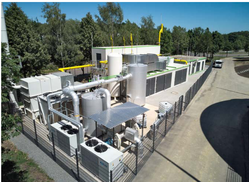
PSA-Gasaufbereitungsanlage der Biogaspartner Bitburg GmbH mit einer Rohgaskapazität von 1.800 Nm 3 /h.
